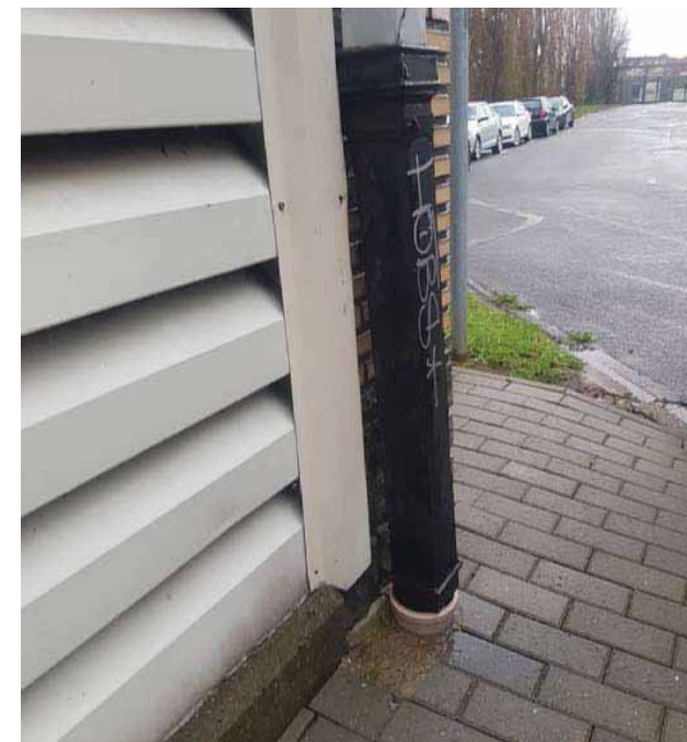
| Descente d'eau pluviale facilement déconnectable - bâtiment technique Elia source : photographie Arter ©
